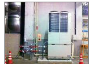
空水冷式ヒートポンプ
