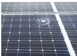
写真5. パネル破損例
