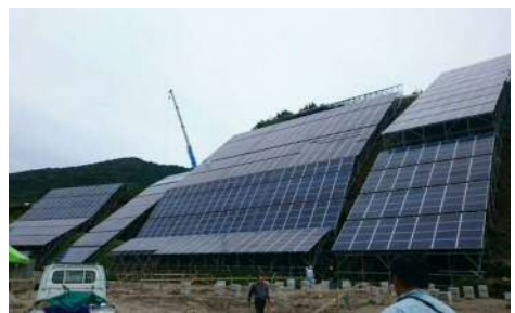
写真 4. 斜面を利用した設置例
