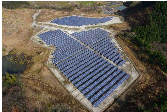
写真 9. 西秋沢太陽光発電所 (増設後)
