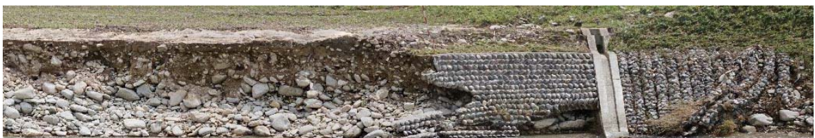
写真-6 オルソ画像による護岸被災状況
